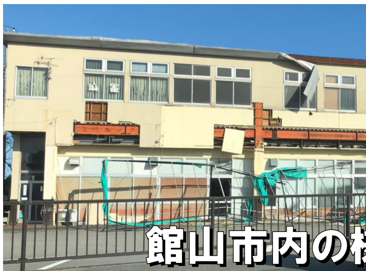
屋根が壊れた東千葉駅
